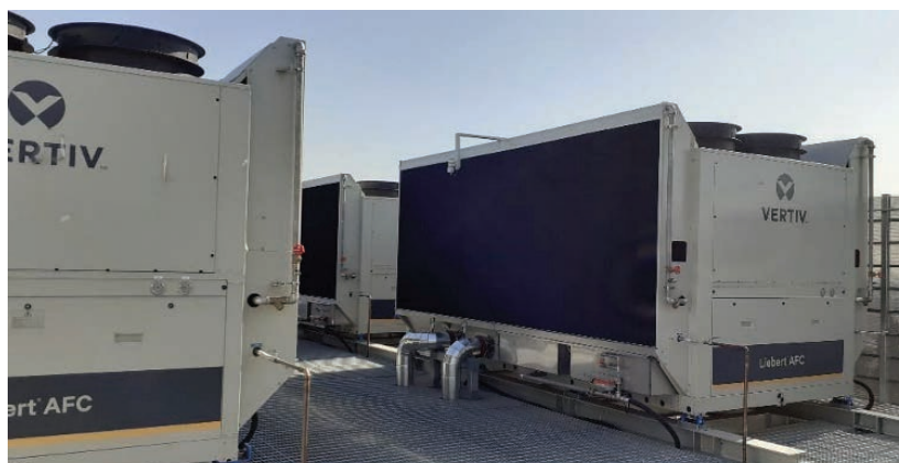
Figura 12. Chillers Vertiv Liebert AFC com serpentinas adiabáticas (pretas).
