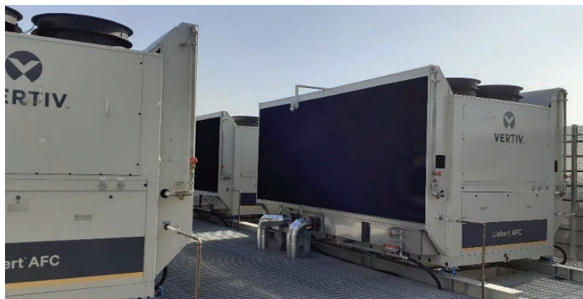
Figura 12. Enfriadores Vertiv Liebert AFC con serpentines adiabáticos (negros).
