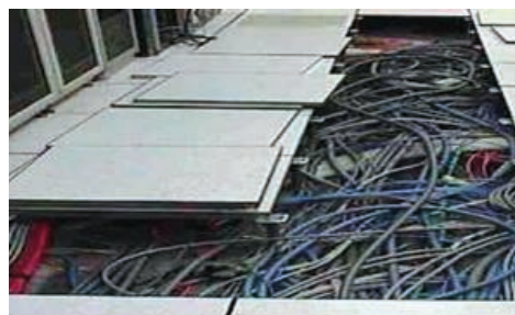
Data Center Típico com Cabos de Alimentação e Conduítes
