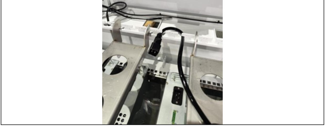
Şekil 7.7 Sunucu güç ve veri kablolarının düzeltilmesi
