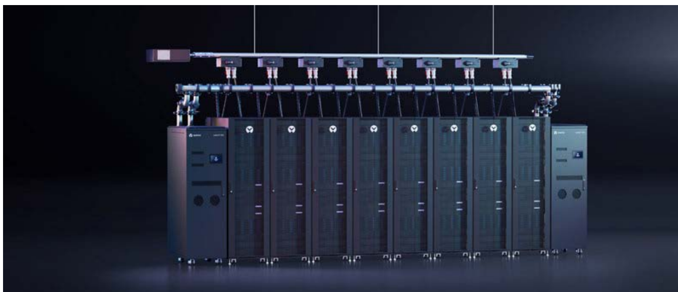
Racks refrigerados por líquido soportada por la Vertiv™ CoolChip CDU y la red de fluidos secundaria.
