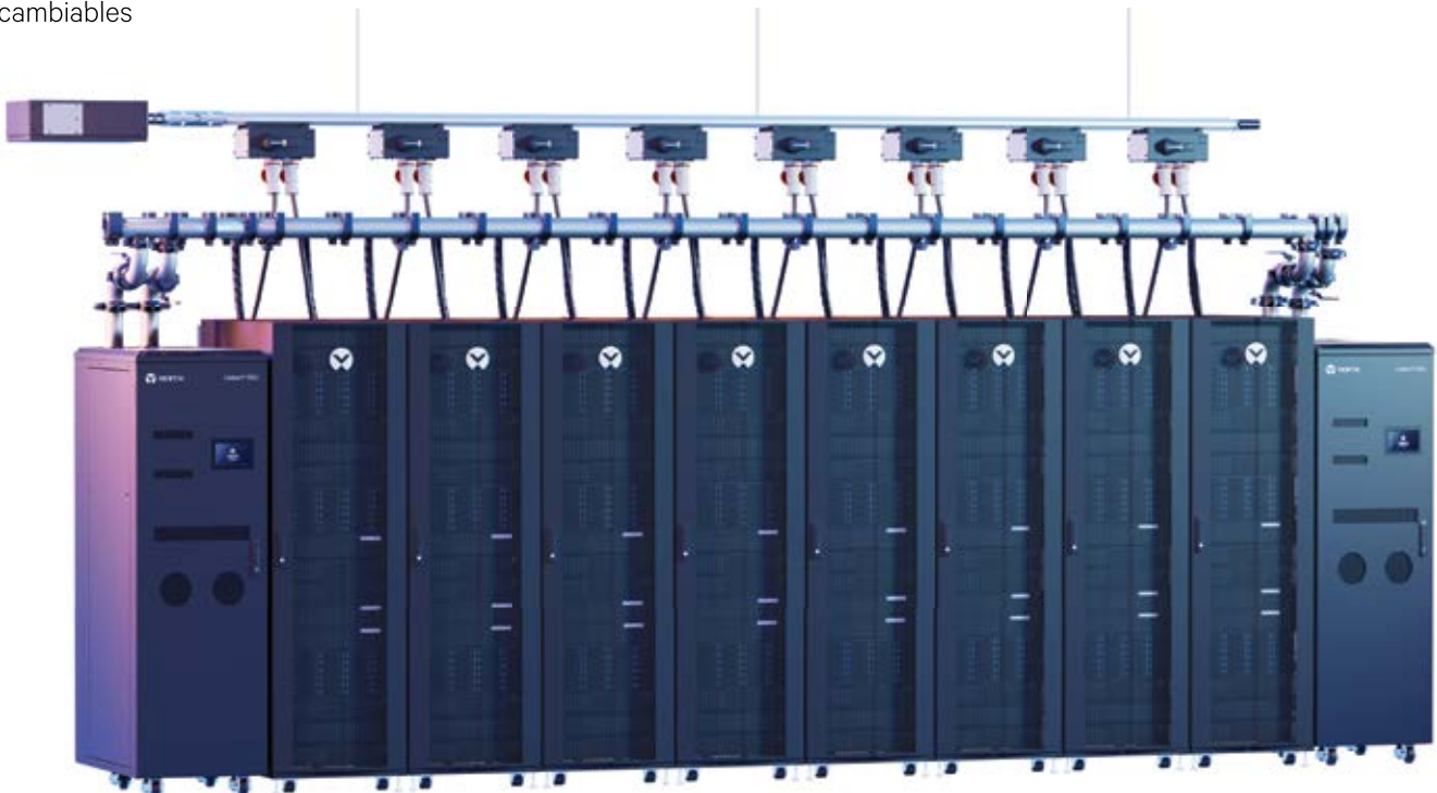
Cajas de conexión
