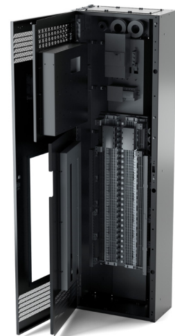
Figura 2. Liebert® RXA (vista interna)
